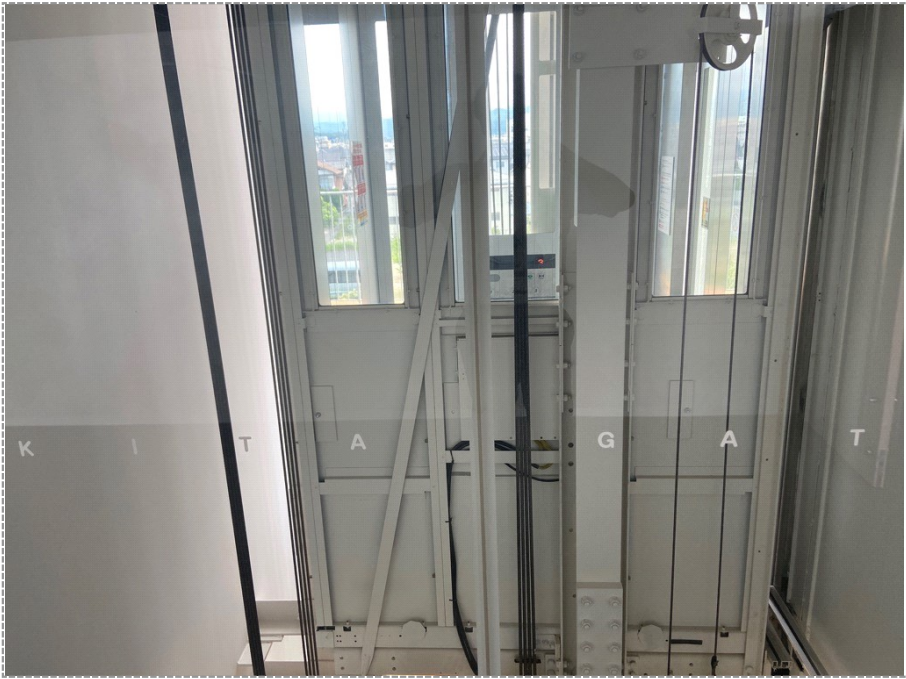
エレベーター
