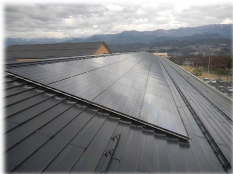
高森中学校（屋根）の太陽光パネル
